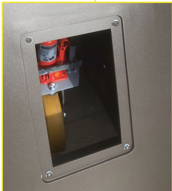
Zoom sur la trappe d'accès.
